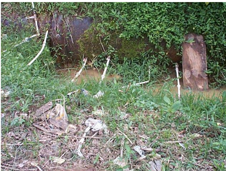
FLAGRANTE DE LIGAÇÕES CLANDESTINAS EM ADUTORA
