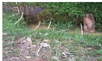
Flagrante de ligações clandestinas em adutora
