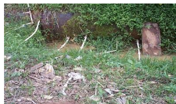
Flagrante de ligações clandestinas em adutora
