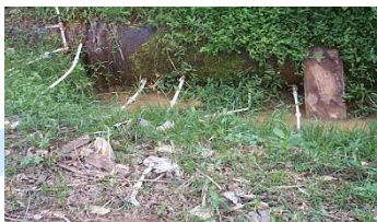
Flagrante de ligações clandestinas em adutora
