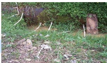
Flagrante de ligações clandestinas em adutora
