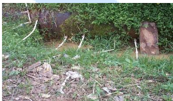
Flagrante de ligações clandestinas em adutora
