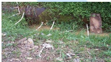
Flagrante de ligações clandestinas em adutora
