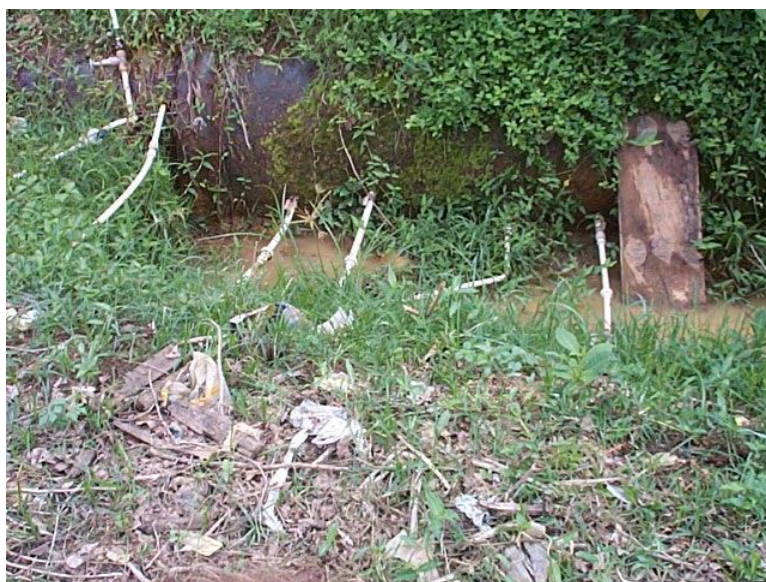
FLAGRANTE DE LIGAÇÕES CLANDESTINAS EM ADUTORA
