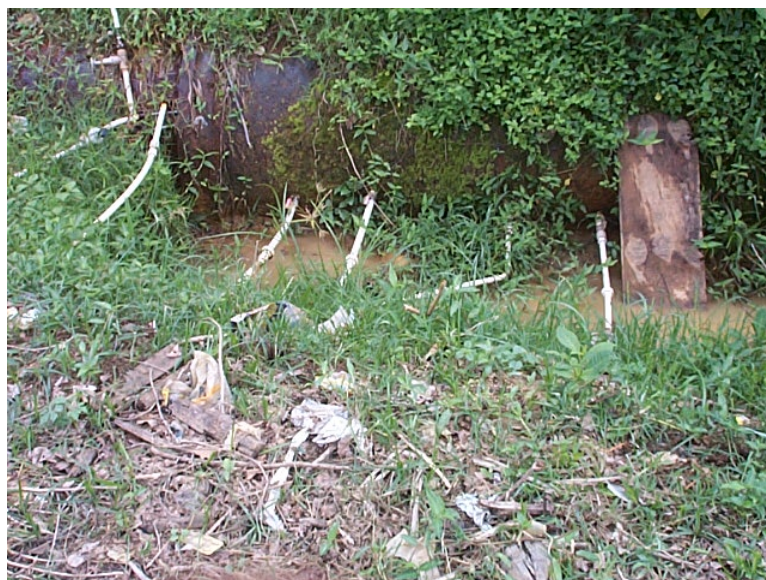
FLAGRANTE DE LIGAÇÕES CLANDESTINAS EM ADUTORA
