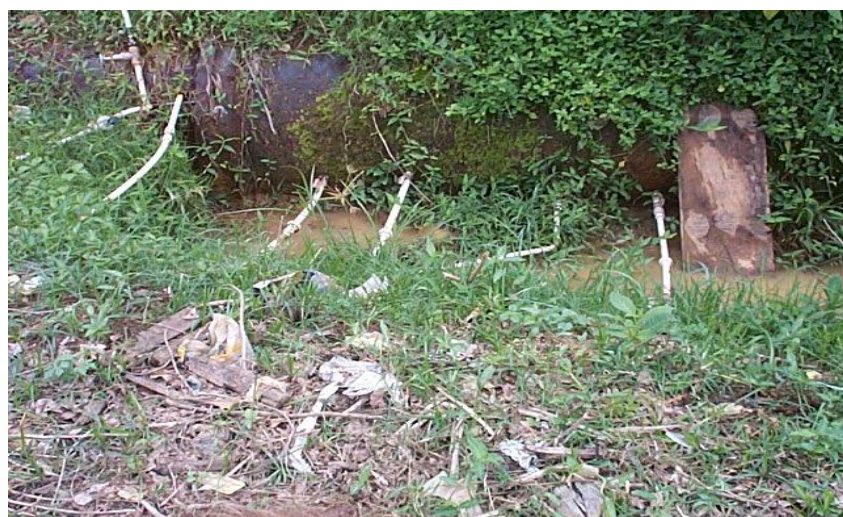
FLAGRANTE DE LIGAÇÕES CLANDESTINAS EM ADUTORA
