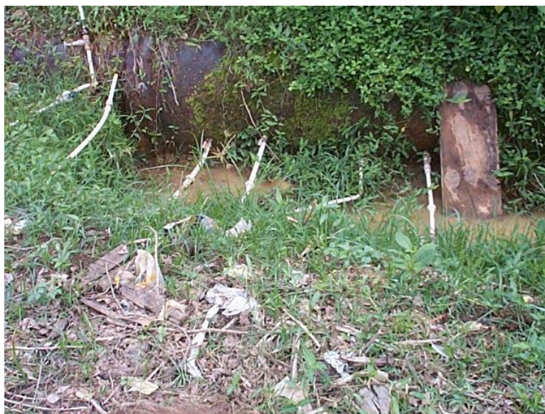
FLAGRANTE DE LIGAÇÕES CLANDESTINAS EM ADUTORA
