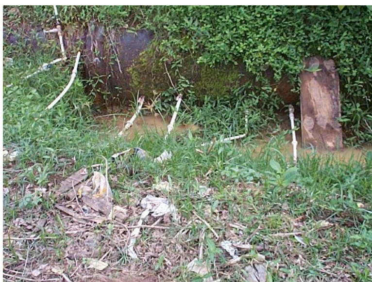
FLAGRANTE DE LIGAÇÕES CLANDESTINAS EM ADUTORA
