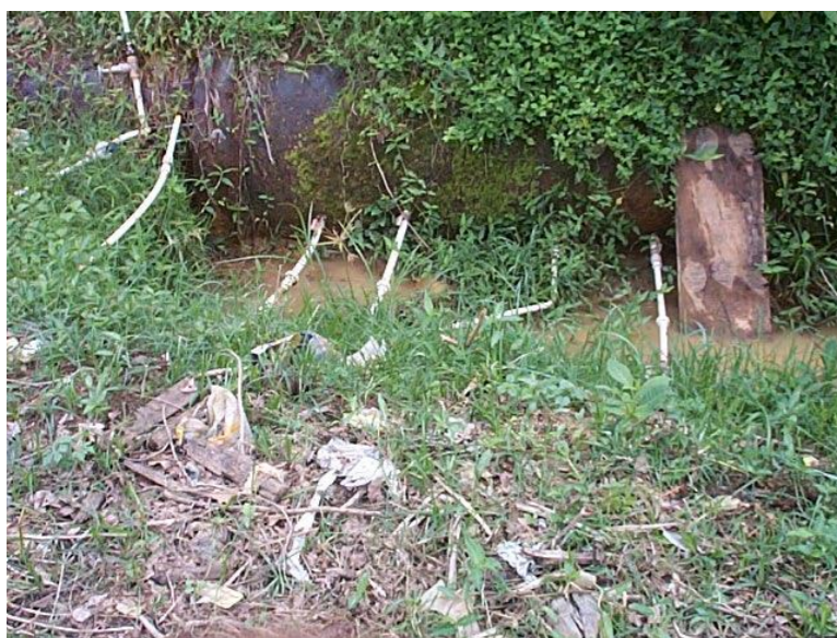
FLAGRANTE DE LIGAÇÕES CLANDESTINAS EM ADUTORA
