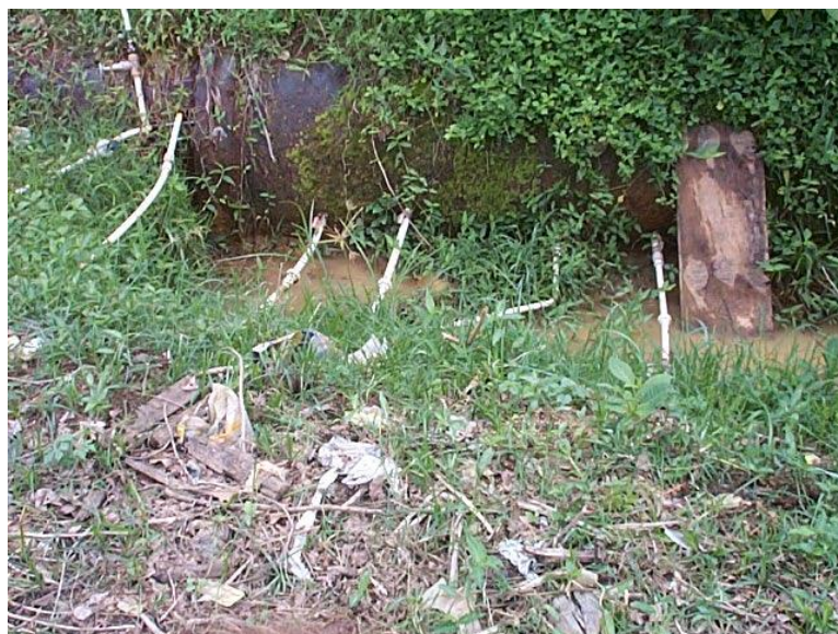
FLAGRANTE DE LIGAÇÕES CLANDESTINAS EM ADUTORA
