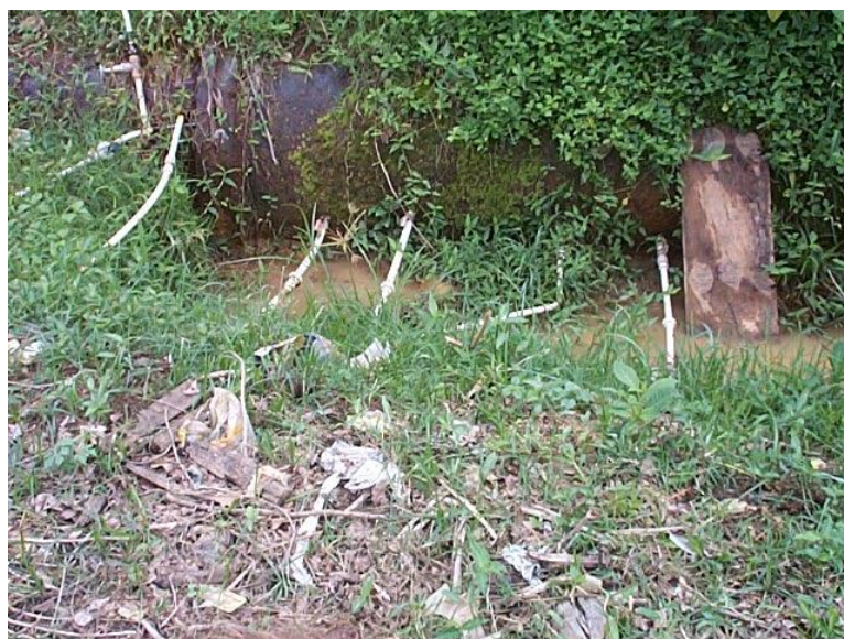
FLAGRANTE DE LIGAÇÕES CLANDESTINAS EM ADUTORA
