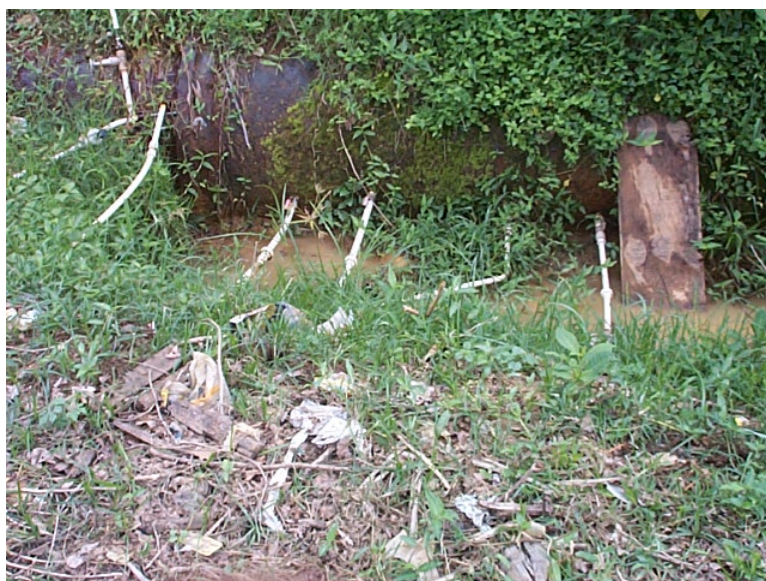
FLAGRANTE DE LIGAÇÕES CLANDESTINAS EM ADUTORA
