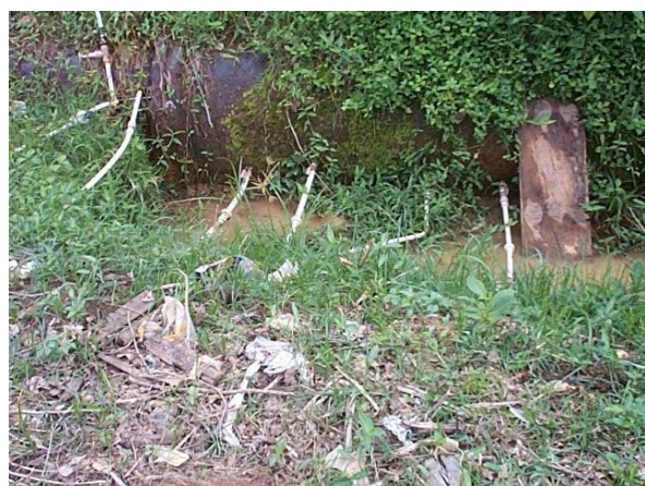
FLAGRANTE DE LIGAÇÕES CLANDESTINAS EM ADUTORA
