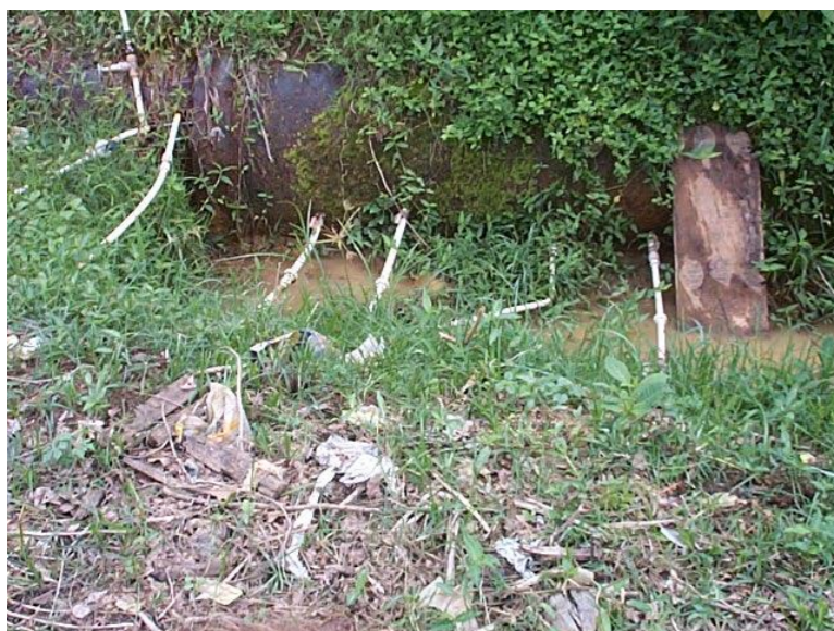
FLAGRANTE DE LIGAÇÕES CLANDESTINAS EM ADUTORA
