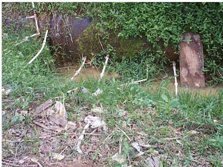
FLAGRANTE DE LIGAÇÕES CLANDESTINAS EM ADUTORA
