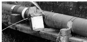
Flagrante de ligações clandestinas em adutora
