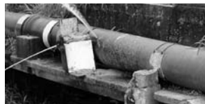
Flagrante de ligações clandestinas em adutora
