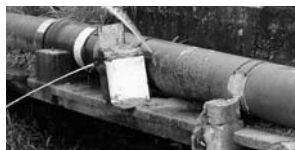
Flagrante de ligações clandestinas em adutora
