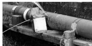
Flagrante de ligações clandestinas em adutora
