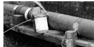
Flagrante de ligações clandestinas em adutora
