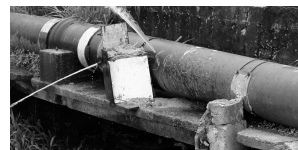
Flagrante de ligações clandestinas em adutora
