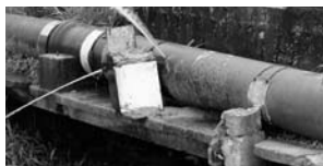
Flagrante de ligações clandestinas em adutora
