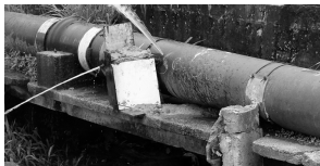
Flagrante de ligações clandestinas em adutora
