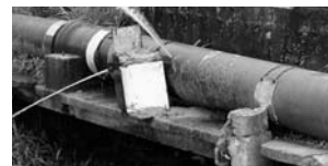
Flagrante de ligações clandestinas em adutora
