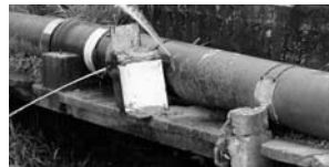
Flagrante de ligações clandestinas em adutora
