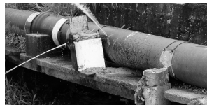
Flagrante de ligações clandestinas em adutora
