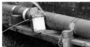
Flagrante de ligações clandestinas em adutora
