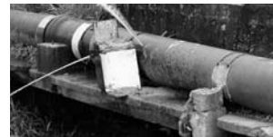
Flagrante de ligações clandestinas em adutora
