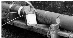
Flagrante de ligações clandestinas em adutora
