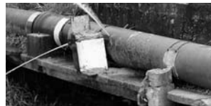
Flagrante de ligações clandestinas em adutora
