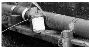
Flagrante de ligações clandestinas em adutora
