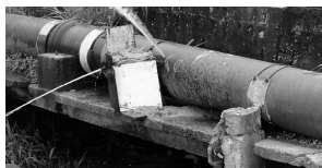
Flagrante de ligações clandestinas em adutora
