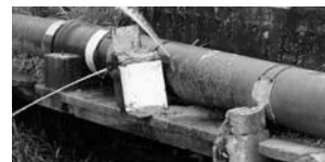
Flagrante de ligações clandestinas em adutora
