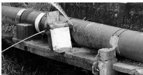
Flagrante de ligações clandestinas em adutora
