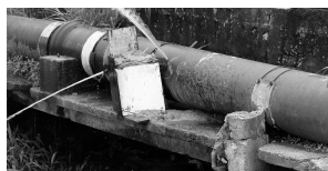
Flagrante de ligações clandestinas em adutora
