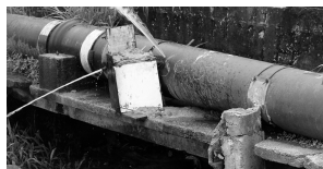
Flagrante de ligações clandestinas em adutora
