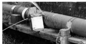
Flagrante de ligações clandestinas em adutora
