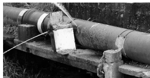
Flagrante de ligações clandestinas em adutora
