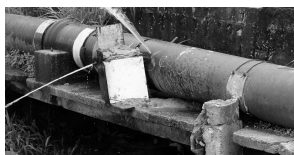
Flagrante de ligações clandestinas em adutora
