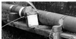
Flagrante de ligações clandestinas em adutora
