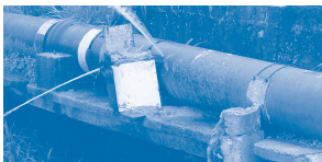
Flagrante de ligações clandestinas em adutora
