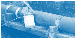
Flagrante de ligações clandestinas em adutora
