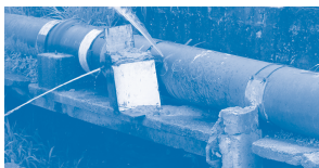
Flagrante de ligações clandestinas em adutora
