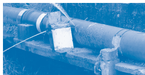
Flagrante de ligações clandestinas em adutora
