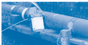
Flagrante de ligações clandestinas em adutora
