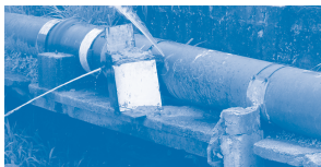
Flagrante de ligações clandestinas em adutora
